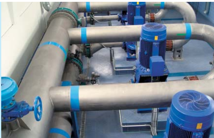
Zespół pomp wody uzdatnionej do sieci wodociągowej
