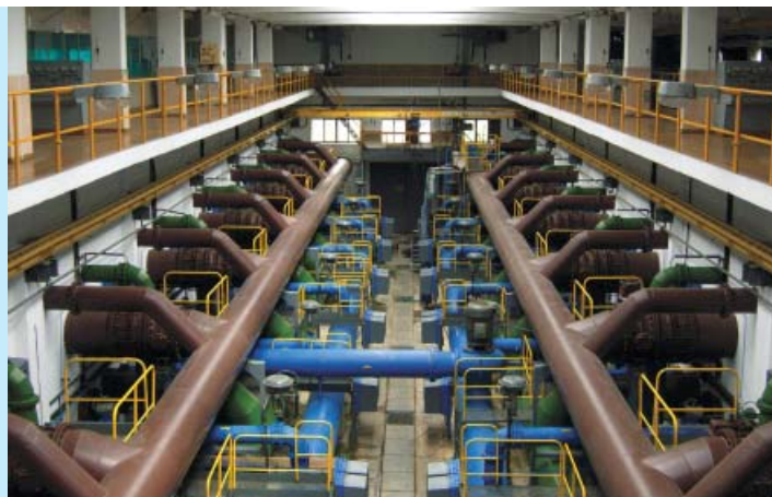
Saur Neptun Gdańsk – hala filtrów na ujęciu powierzchniowym wody w Straszynie od 1986 r. zaopatruje w wodę 1/3 mieszkańców Gdańska
