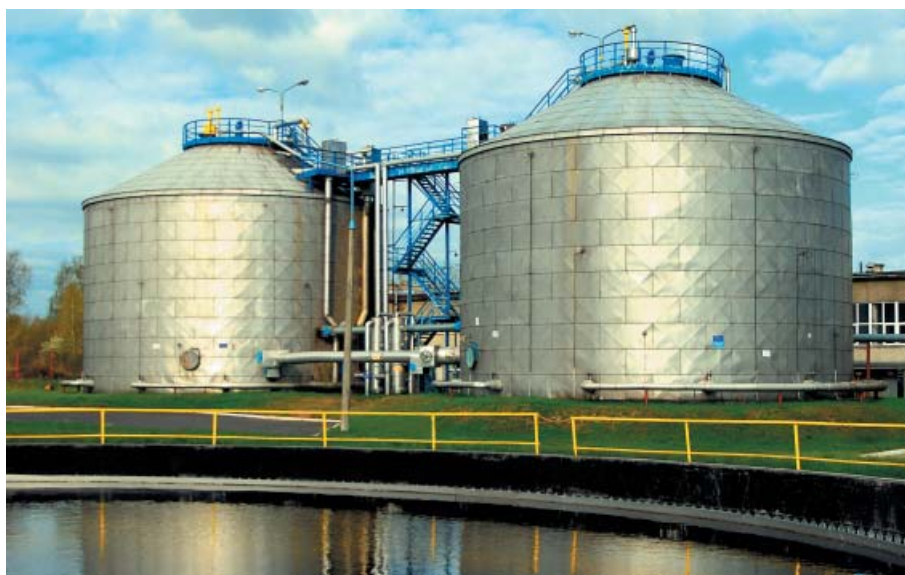
Zamknięte komory fermentacyjne oczyszczalni ścieków
