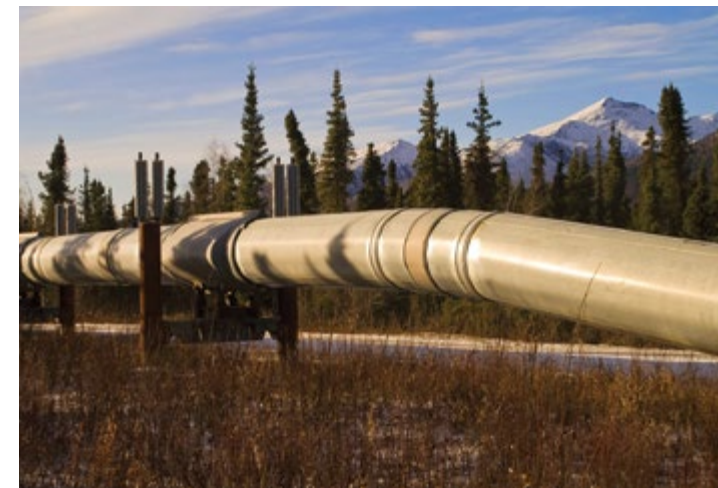
Rurociąg Enbridge w Kanadzie / The Enbridge Oil Pipeline in Canada
