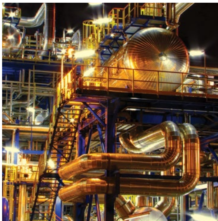
Destylacja rurowo-wieżowa w trzebińskiej rafinerii / Tubular-tower distillation at the refinery in Trzebinia
