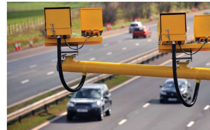
Na autostradach i drogach ekspresowych ze względu na duże prędkości rozwijane przez kierowców istotna jest kontrola i stały monitoring
