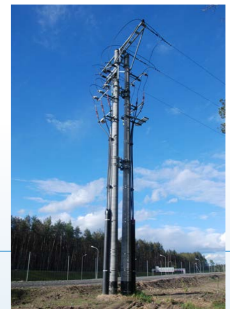
▼ Stanowisko słupowe SN 15kV 15kV MV power line pole with connectors
